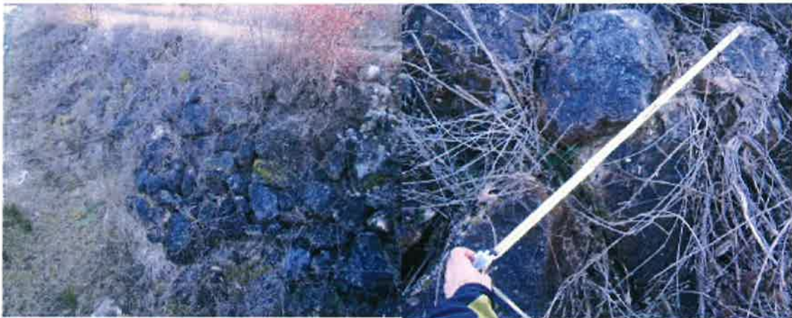
Vue (ensemble et détail) sur l'enrochement en place au niveau de la digue en rive gauche
